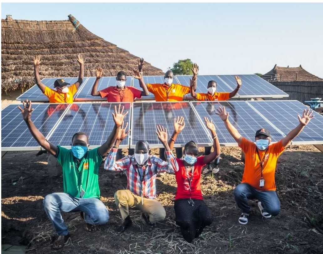
En 2020 se instalaron paneles solares en la oficina del NRC en Mankien, Sudán del Sur. Ahora el equipo tiene su propio suministro de energía y disfruta de la energía renovable durante las 24 horas del día, los 7 días de la semana. Foto: Iban Colón/NORCAP
